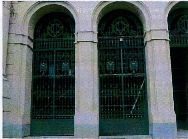
(F-180) Cerrajería en puertas acceso
