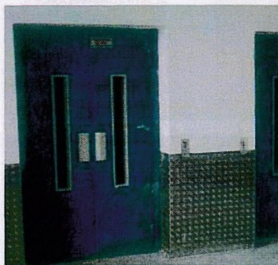
(F-231) Montacargas en acceso calle Correos
