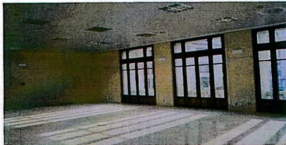
(F-247) Falso techo zona trabajo
